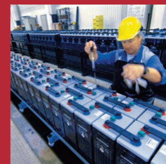
Batteriewartung im XXL-Format: Die 15 Sekunden bis zum Start der Notstromaggregate werden von Batterien überbrückt. Die Wartung dauert einen halben Tag und wird monatlich durchgeführt.
