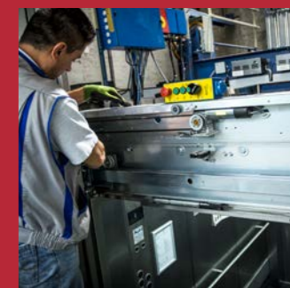
Regelmäßige Wartung für zuverlässige Aufzugsfunktion. Für den Fall der Fälle ist unser Störungsdienst Tag und Nacht in Bereitschaft.
