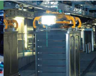
Die automatische Warentransportanlage vom Schnarrenberg: Das umfangreiche Schienennetz und 480 Transportwagen wollen vom tba gepflegt werden.
