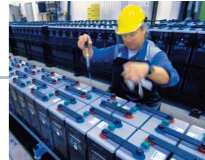
Batteriewartung im XXL-Format: Die 15 Sekunden bis zum Start der Notstromaggregate werden von Batterien überbrückt. Die Wartung dauert einen halben Tag und wird monatlich durchgeführt.
