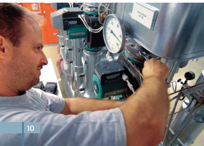
Vorbereiten einer Reservepumpe zum Einbau in den Heizkreislauf: Die Pumpe wird zentral gesteuert.
